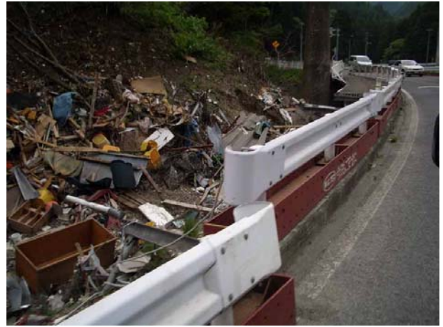
歩道が無くなっている
