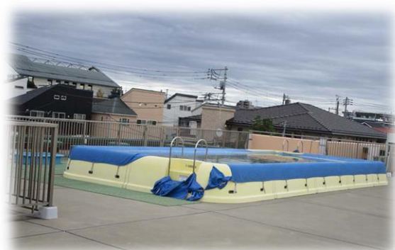
屋上のプールは火災などの非常時にも対応できる
