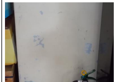
内部壁 ひび割れ・塗装剥がれ
