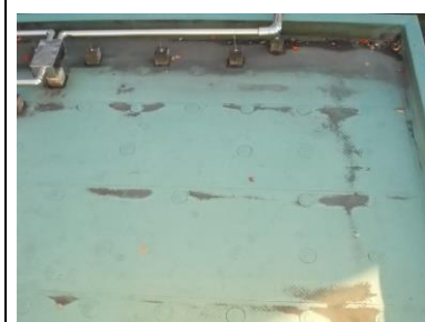
屋上 浮き・排水不良
