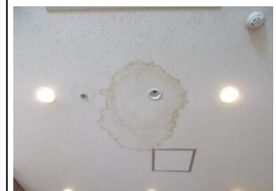
内部 天井に漏水痕
