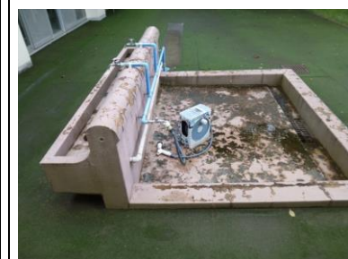
足洗い場 塗装剥がれ、ひび割れ
