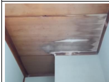
湯沸室天井 雨漏痕
