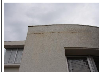
南側外壁 ひび割れ・錆汁
