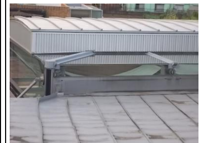
屋上 金属屋根ハゼ部の破損
