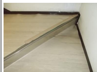
内部階段 シートの剥がれ、膨れ
