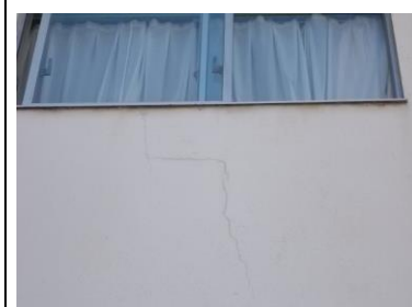
外壁 ひび割れ
