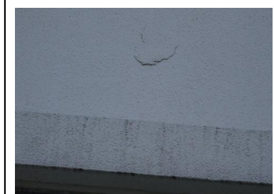
外壁 軽微な膨れ
