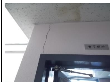
内部壁 ひび割れ
