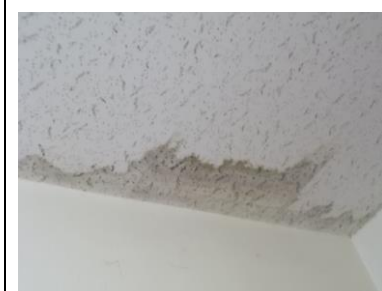
トイレ天井 漏水痕
