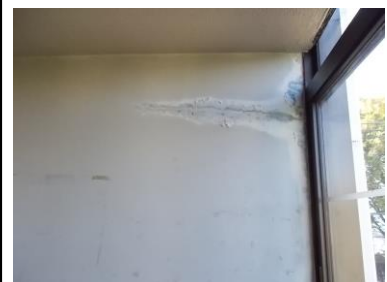
階段 外部開口部から 浸水による塗装剥離
