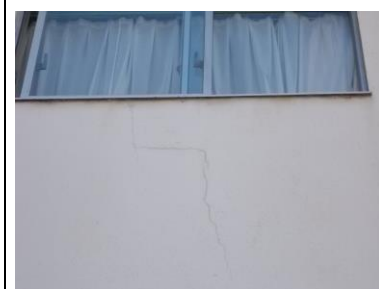
外壁 ひび割れ
