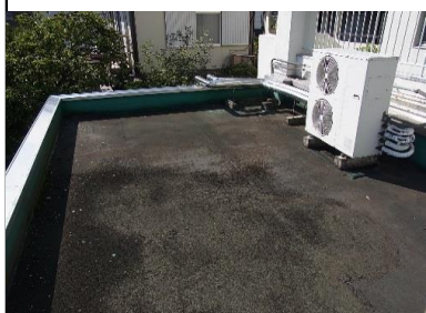
屋上 表層摩耗
