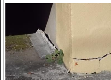
外壁 ひび割れ
