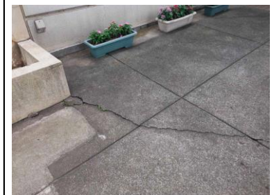
外構 ひび割れ
