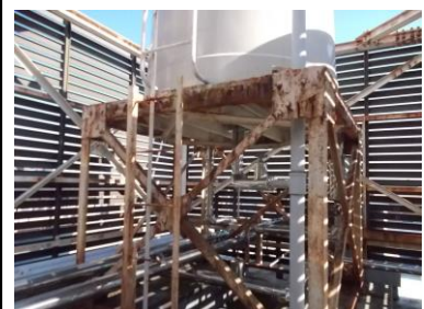
屋上 高架タンク架台の発錆
