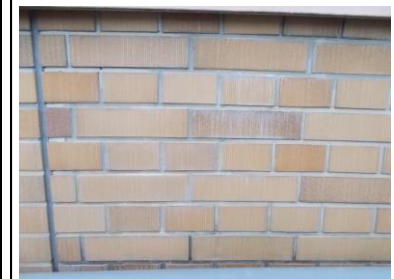
外壁 エフロレッセンス
