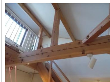
内部梁 ひび割れ
