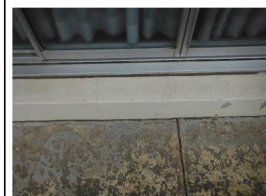
外壁 軽微なひび割れ
