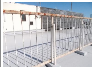
屋上 鉄部に発錆
