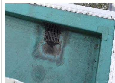
屋上 軽微な劣化
