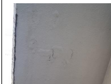
軒天 塗膜剥離
