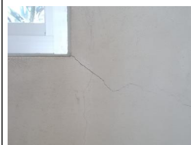
内部壁 ひび割れ
