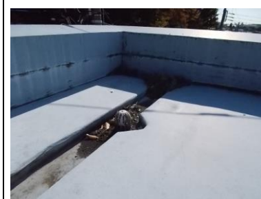
屋上 排水不良・塗装剥離
