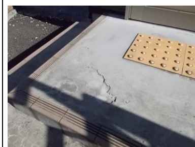
外部床 剥がれ・ひび割れ
