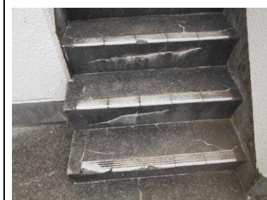
外階段 ひび割れ・破損
