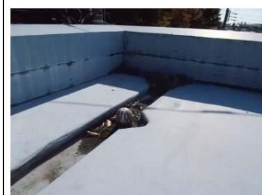
屋上 排水不良・塗装剥離
