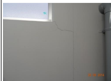
多目的トイレ クラック
