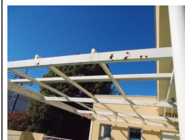
外部鉄部 塗装剥がれ・錆
