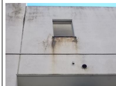
外壁 ひび割れ・錆汁・塗膜剥離
