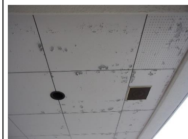
玄関庇軒天 塗装剥離
