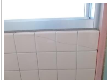
トイレタイル ひび割れ
