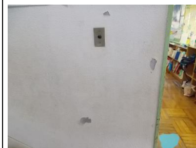
内部壁 塗装剥離
