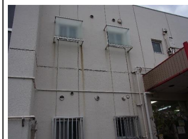
外壁 ひび割れ・錆汁
