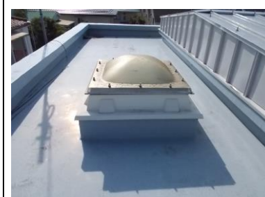
屋上 トップライト劣化
