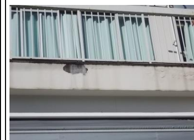
外壁 塗膜剥離
