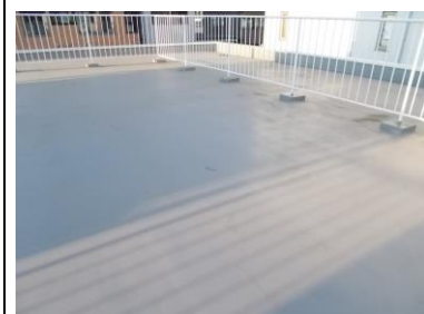
屋上防水 良好
