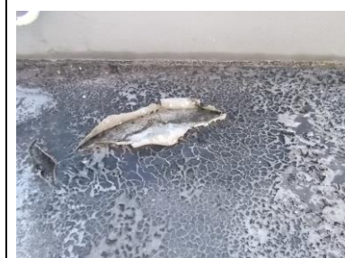
屋上 防水層に破損
