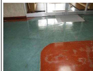
床面 ひび割れ
