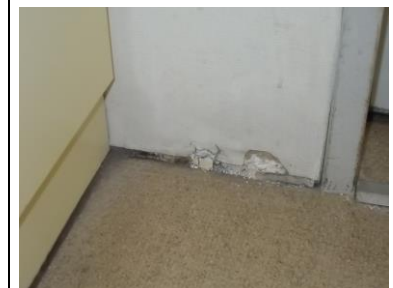
内部壁 欠損・クロス剥がれ
