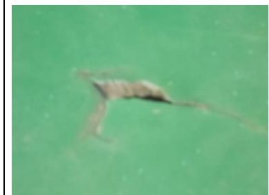
ベランダ防水 欠損
