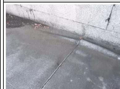
屋上 防水膨れ
