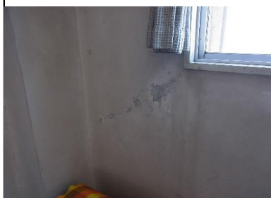
内部壁 外壁から漏水
