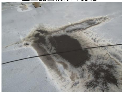
屋上露出防水の劣化
