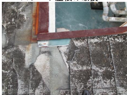
スレート屋根の破損
