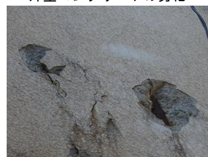
外壁コンクリートの劣化
