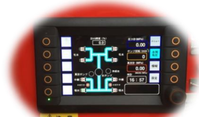
水を吸い上げ火災現場に水を送る
