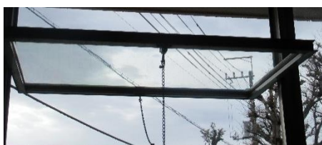
排煙窓もあけています
