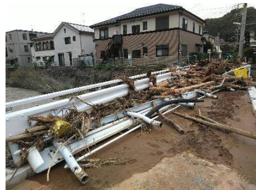
八王子市 令和元年東日本台風の被害
