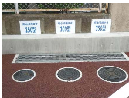
市役所で普及用に展示されている雨水浸透ます
