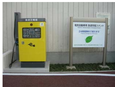
市役所に設置された電気自動車用急速充電器
