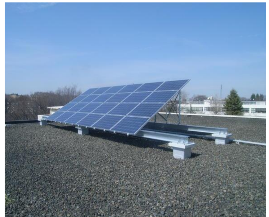
市役所本庁舎屋上の太陽光発電システム
