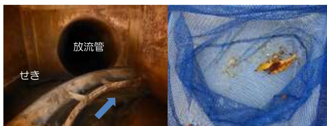
きょう雑物除去施設（写真手前）
