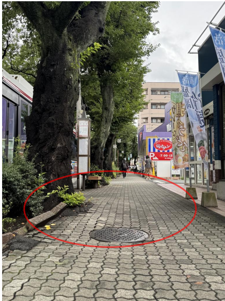
▲東側歩道部 →桜の根上がりによる歩道の凹凸 植栽ブロックの破損
