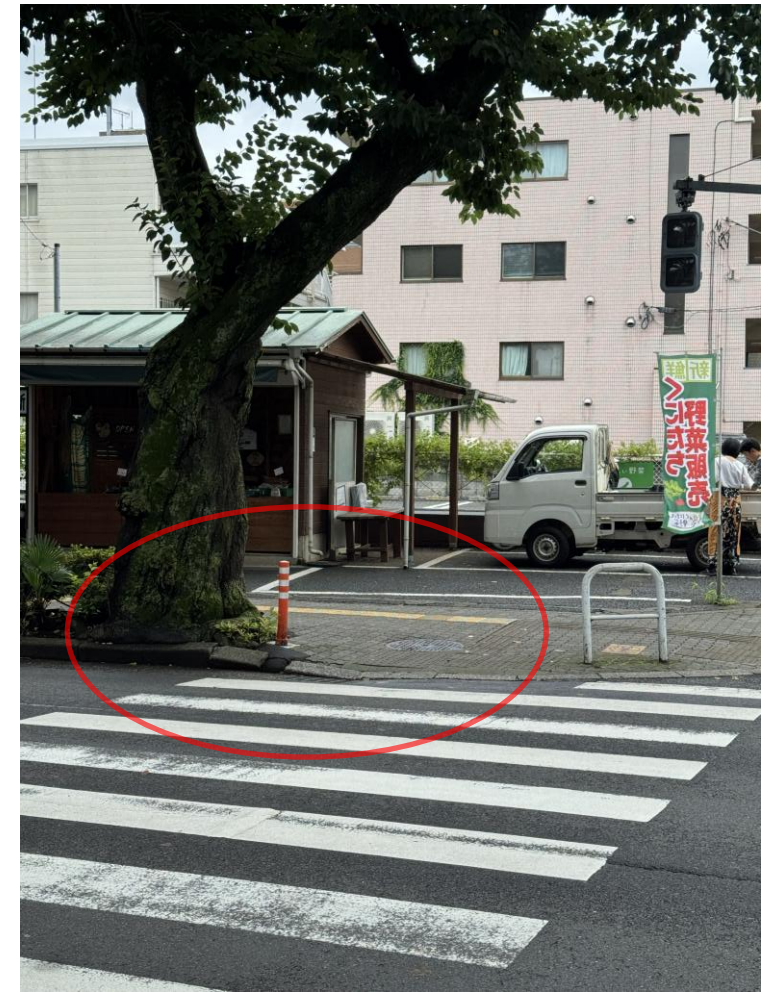
▲西側歩道部 →桜の根上がりによる歩道の凹凸 植栽ブロックの破損
