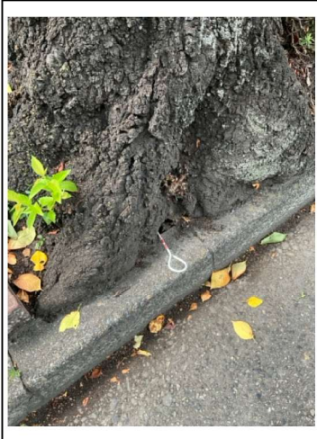
鋼棒貫入異常
