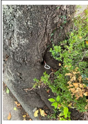
鋼棒貫入異常
