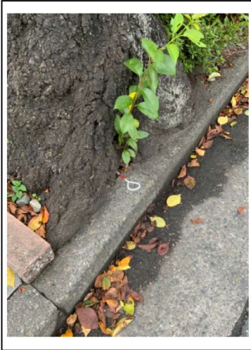
鋼棒貫入異常
