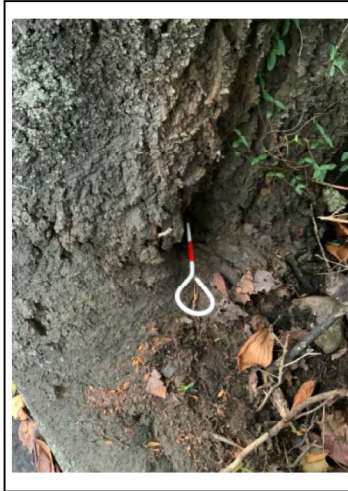
鋼棒貫入異常
