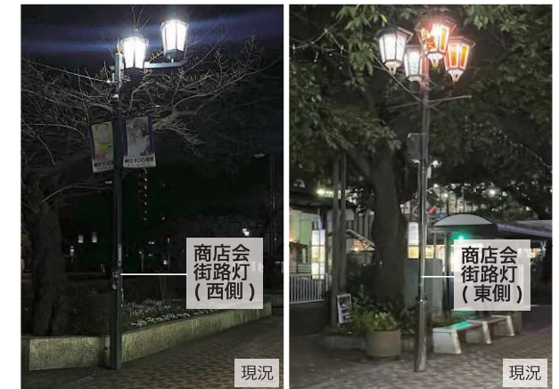
● 既設商店街路灯
