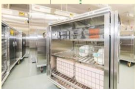
⑪コンテナ室 食缶用と食器用のコンテナ96台があり、学校ごとに分け配送順に並べます。
