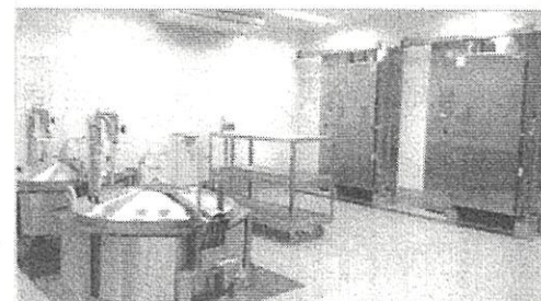
【和え物室】 サラダなどを調理します。 急速冷却機などにより温度管理に注意します。
