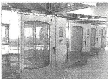
【焼・揚調理室】 蒸し料理も可能なスチームコンベクションオーブンを導入し献立のレパートリーを増します。
