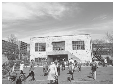
銃撃跡が残る 旧日立航空機株式会社戦災変電所
