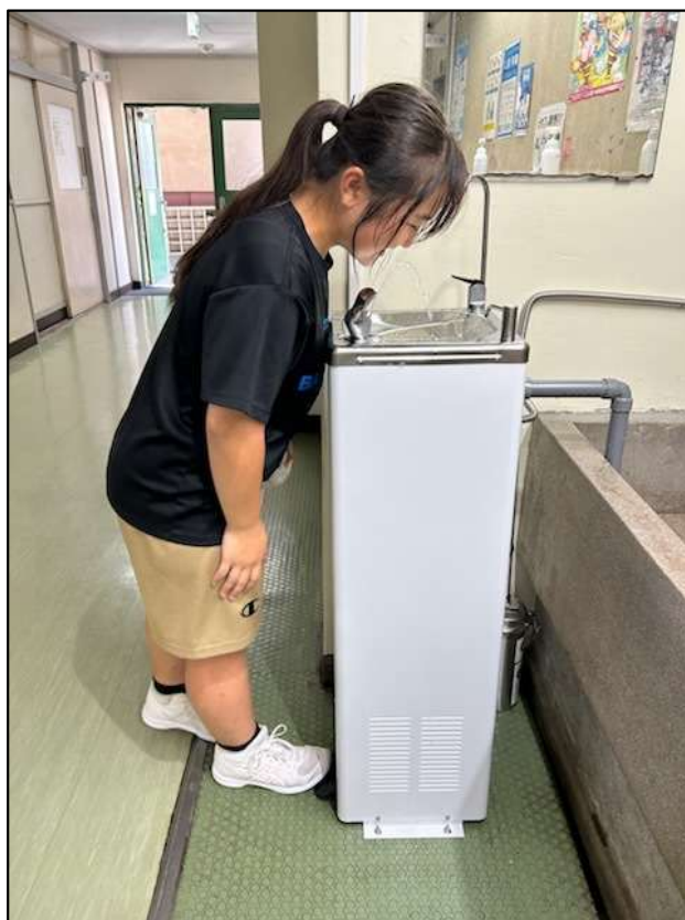
▲令和7(2025)年度に設置した中学校の冷水機。
